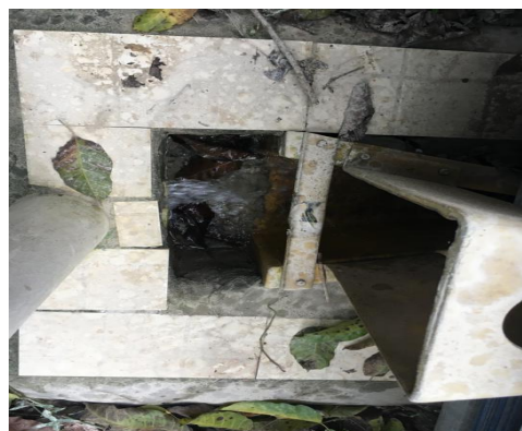
一体化处理设施废水排放口
