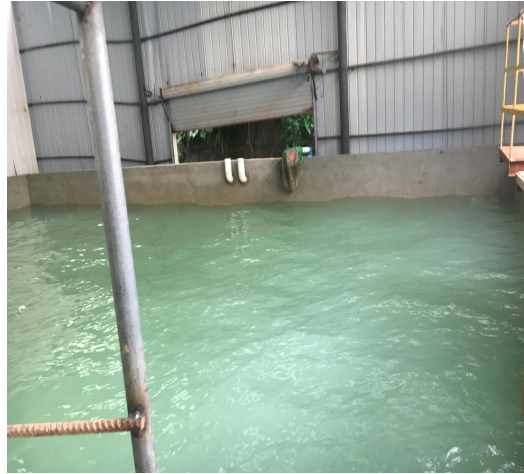
生产废水处理设施——清水池
