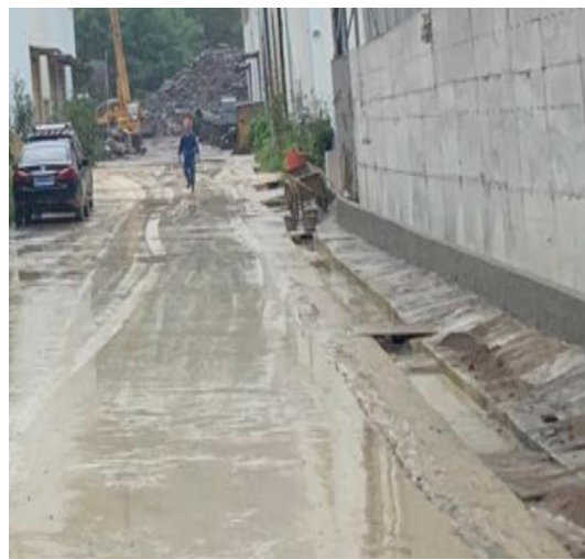
厂区雨水及地面冲洗水收集管沟
