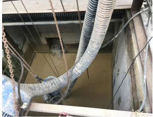
生产废水收集池
