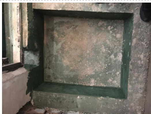
危废暂存间——废液收集井
