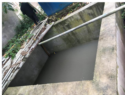
一体化处理设施污水收集池
