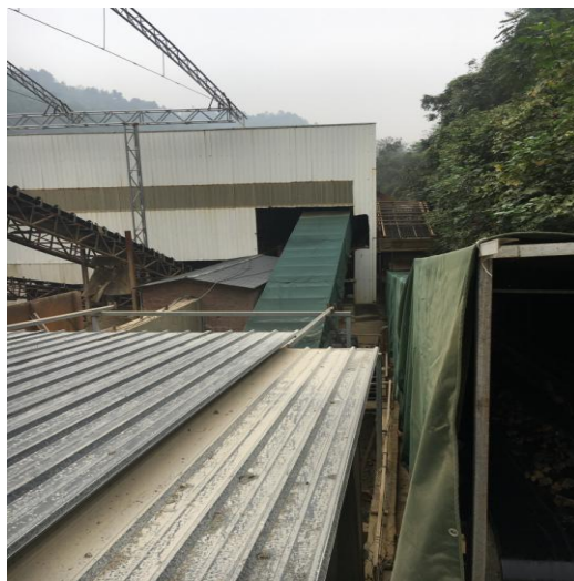
破碎机出料口密闭输送廊道
