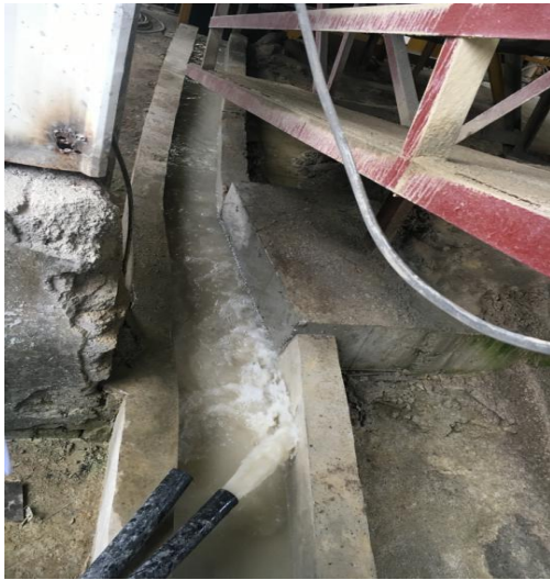
厂房内生产废水收集边沟
