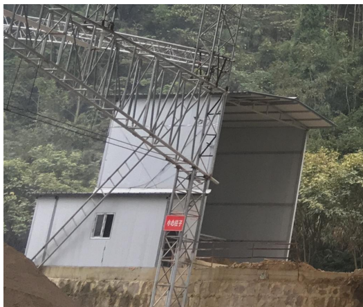
半地下式破碎机设置彩钢棚密闭设施
