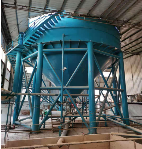
生产废水处理设施——锥形罐
