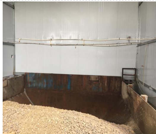
进料口洒水设施
