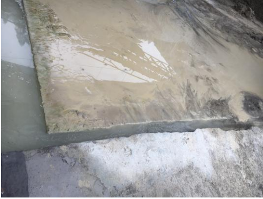
产品堆场废水收集边沟
